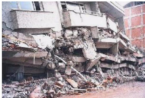
Slika 1.20-Kolaps konstrukcije usled efekta fleksibilnog prizemlja (Turska 1999)
