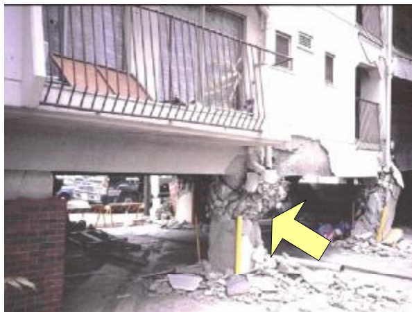
Slika 1.19-Velika oštećenja konstrukcije usled efekta fleksibilnog prizemlja (Japan 1995)
