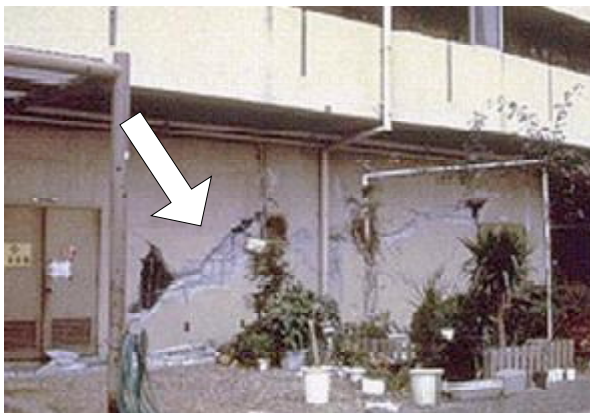
Slika 3.35 - Oštećenja zida nakon zemljotresa
