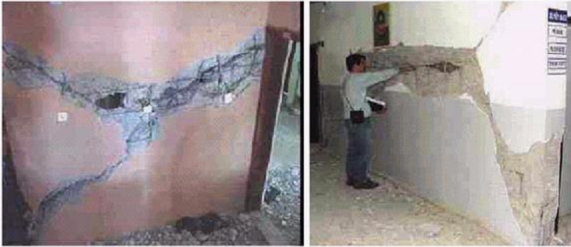
Slika 3.36 - Prekomerna oštećenja zidova pri zemljotresu u Turskoj
