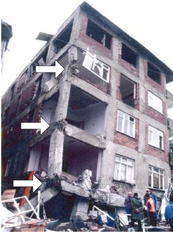
Slika 2.22 - Velika oštećenja-lom ramovske konstrukcije (Turska 1999.)
