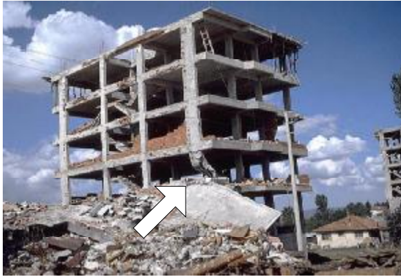
Slika 2.20 - Velika oštećenja ramovske konstrukcije (Turska 1999.)
