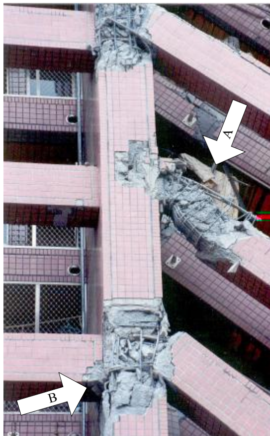
Slika 2.24 - Lom čvorova i greda ramovske konstrukcije (Tajvan 1999.)
