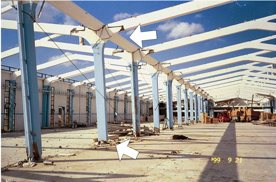
Slika 4.39 - Oštećenja hale u izgradnji (Turska 1999.)
