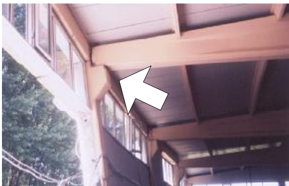
Slika 4.40 - Oštećenje veze stuba i grede
