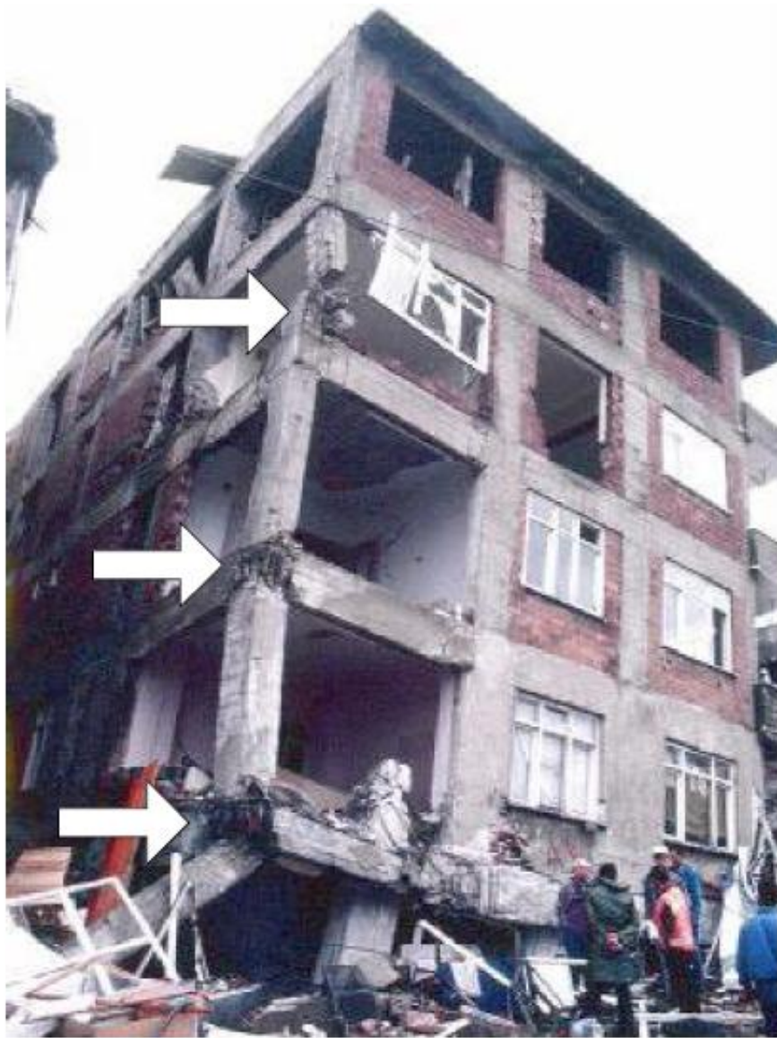
Slika 2.22 - Velika oštećenja-lom ramovske konstrukcije (Turska 1999.)
