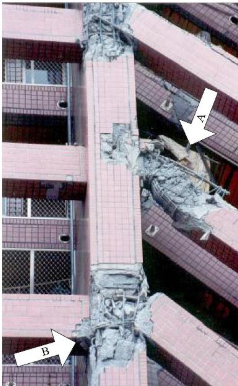
Slika 2.24 - Lom čvorova i greda ramovske konstrukcije (Tajvan 1999.)
