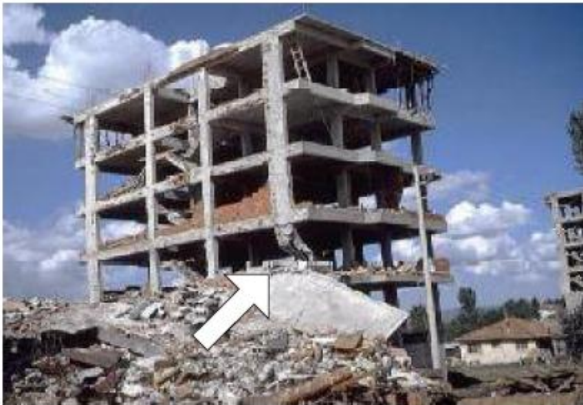
Slika 2.20 - Velika oštećenja ramovske konstrukcije (Turska 1999.)
